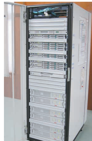
統合図書館システムサーバ(長岡技大図書館)
